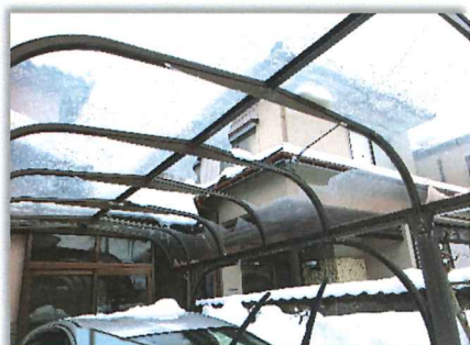
雪の重みにより、カーポートのパネルが割れ、落ちた雪とパネルが車を直撃 (>_<)
