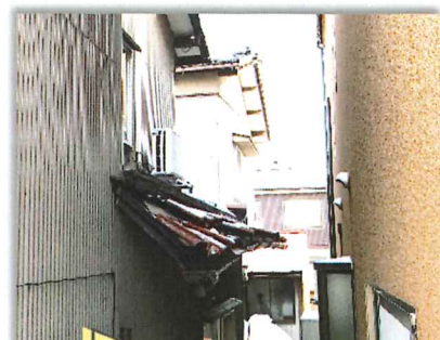
雪の重みと、大屋根からの落雪により瓦が割れました
